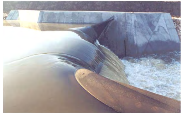
Açude das Salgadas em plena carga (pormenor do insuflável)
