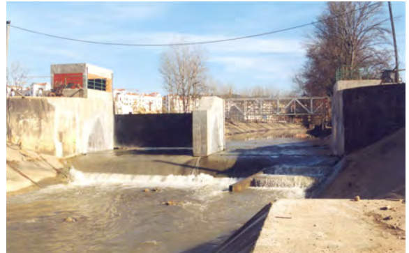
Açude do Arrabalde: vista de jusante dos dois vãos, ensecadeira e casa do comando eléctrico
